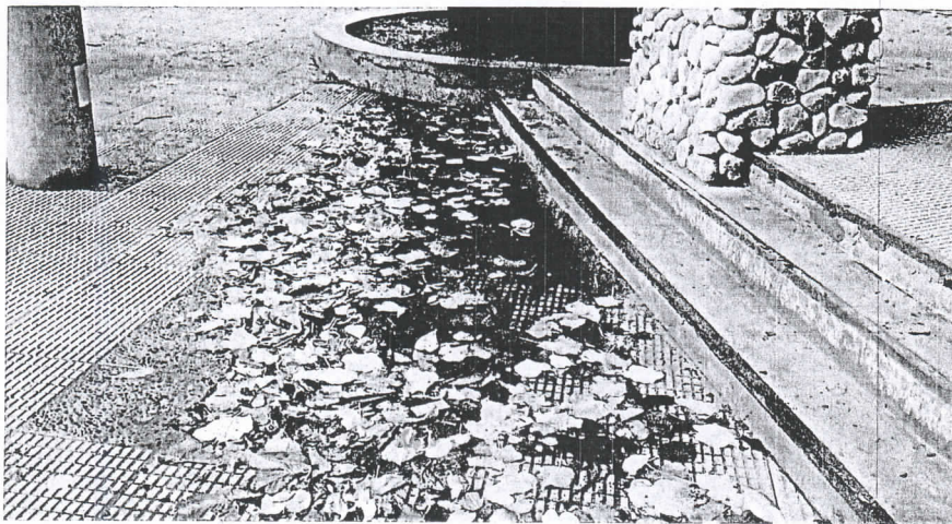
4. Fotografías N°10: Pavimento desnivelado
