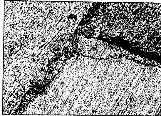
Fotografía N° 10 Lugar: Calle Los Olmos, entre calle Los Lirios y fin de proyecto. Observación: Fisuras y grietas.
